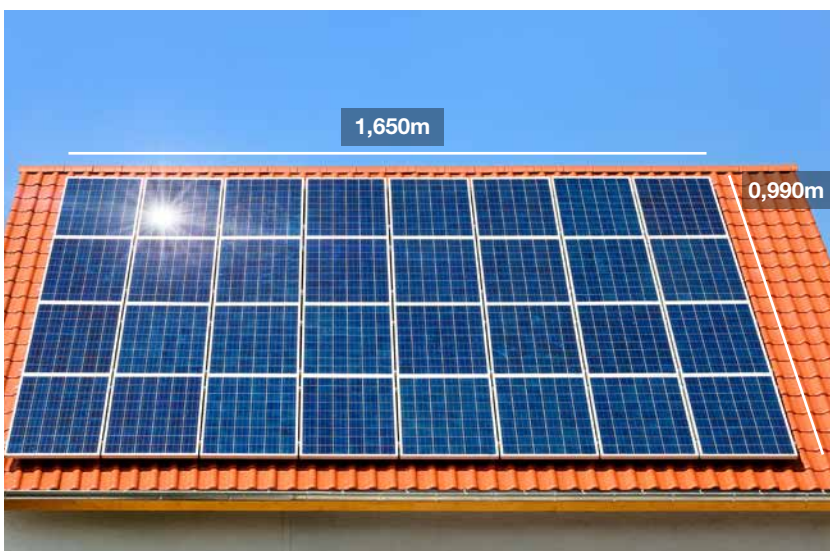
Foto 3//Painel fotovoltaico de silício policristalino de 250 Watts//
